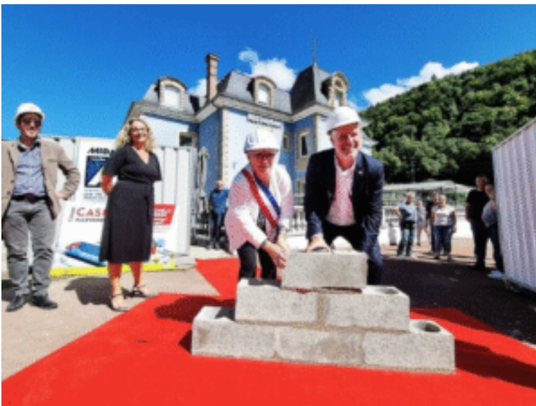
Sébastien Leclercq, la maire Christelle Mégret et Agnès Bretteville la directrice du casino d'Allevard ont lancé le chantier d'agrandissement de l'établissement. Crédit Photo : Le DL / E.D.
